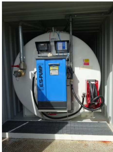
Figure 20 : Cuve de 15 000 litres de GNR placée dans un container (ENCEM)
